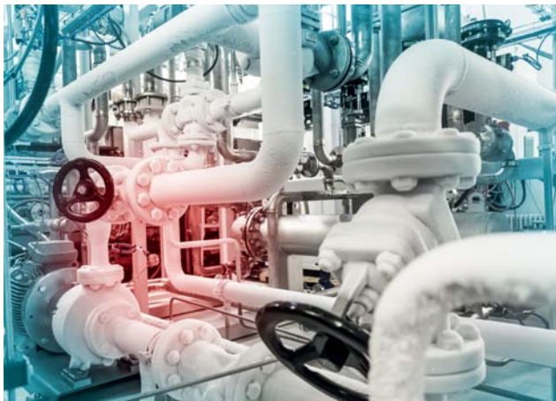
Leistungstests während der Werksabnahme (FAT)
